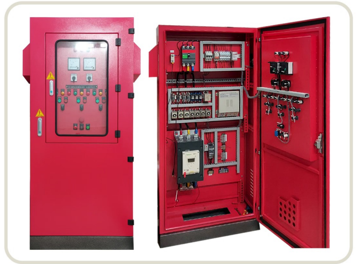
Tủ bơm PCCC
