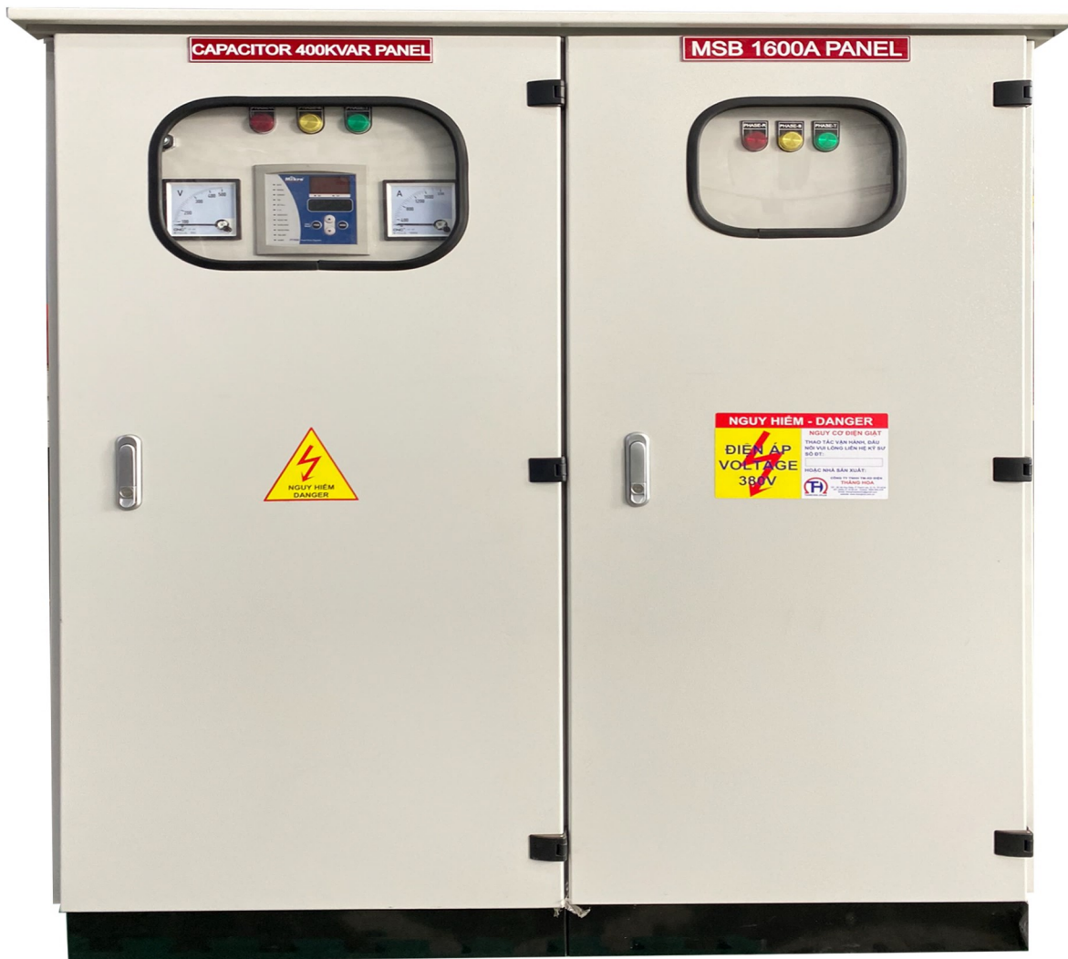
Tủ MSB 1600A & Tủ bù 400kVAR
