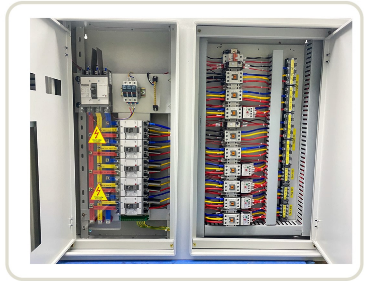
Tủ điều khiển bơm nước - quạt
