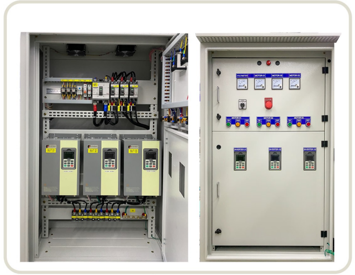
Tủ điều khiển 3 motor 18.5KW
